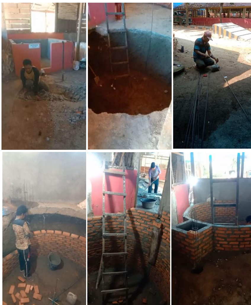
Gambar 3. Tahapan kerja pembangunan biodigester. Dimulai dari pembuatan lubang melingkar, pemasangan alas beton, pemasangan dinding tabung melingkar beserta celas inlet dan outlet.
