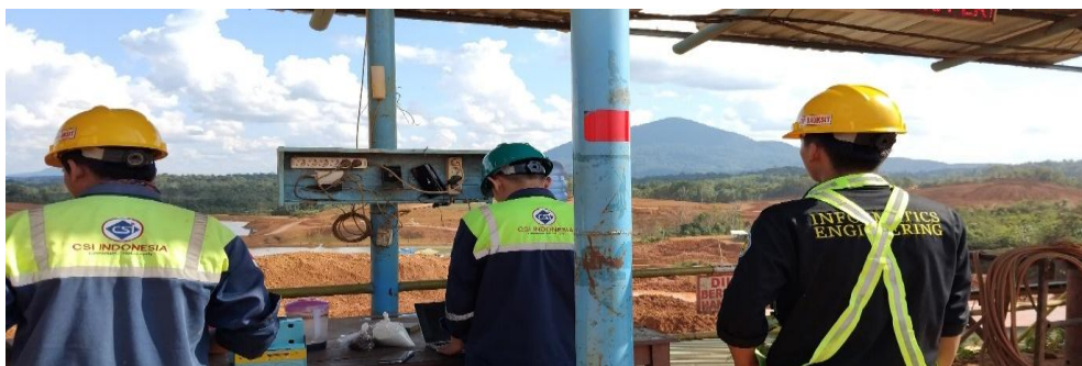
Gambar 1. Pemasangan Router UBNT UBIQUITI di bukit 30
