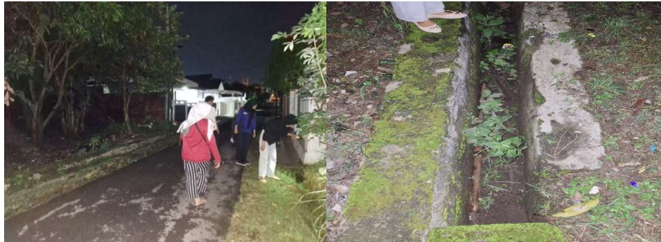
Gambar 3. Kondisi drainase di lokasi observasi Gg. Swadaya VI No.25, Gunung Terang, Kecamatan Langkapura, Kota Bandar Lampung
