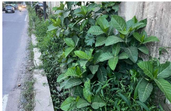
Gambar 5. Kondisi existing saluran drainase banyak tumbuh vegetasi liar yang akan mengurangi kapasitas saluran untuk mengalirkan debit limpasan air hujan
